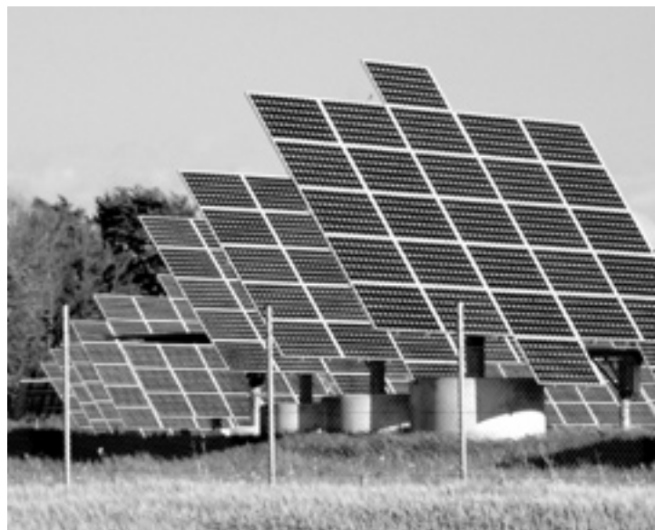
Die alte Bergbaustadt Freiberg erfindet sich gerade neu als sächsisches Zentrum der Erneuerbaren Energien: Photovoltaikanlage in der Nähe von Freiberg, Sachsen. Foto: Eclipse.sx, Creative Commons Lizenz
